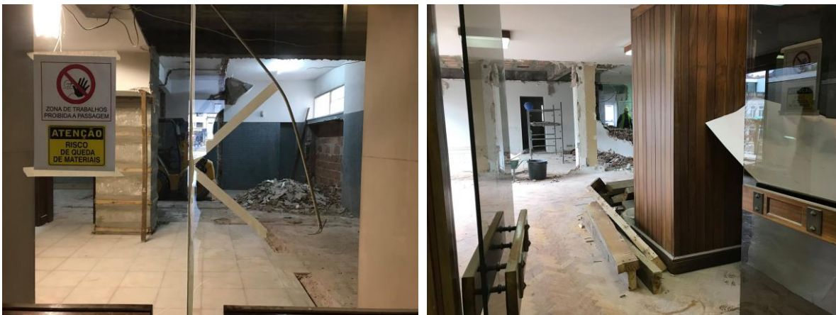
Imagens: Pormenores de algumas áreas em remodelação. Imagem à esquerda: Novo espaço do Serviço Educativo. Imagem à direita: Centro Português do Surrealismo.
